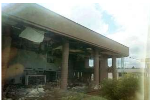
東日本大震災による損壊(福島県)
